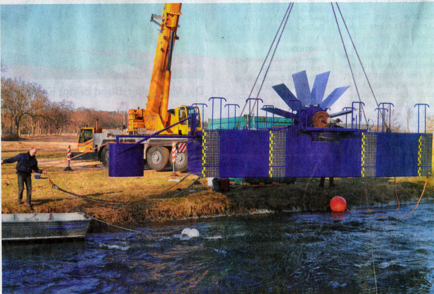
Der große Moment: Nach mehreren Stunden Vorbereitung senkt sich das Kleinkraftwerk in die Warnow an der Sagsdorfer Brücke. Wissenschaftler der Uni Rostock wollen mit dem Wasserrad drei Wochen lang Strom erzeugen und Einflüsse auf die Umwelt festhalten.
